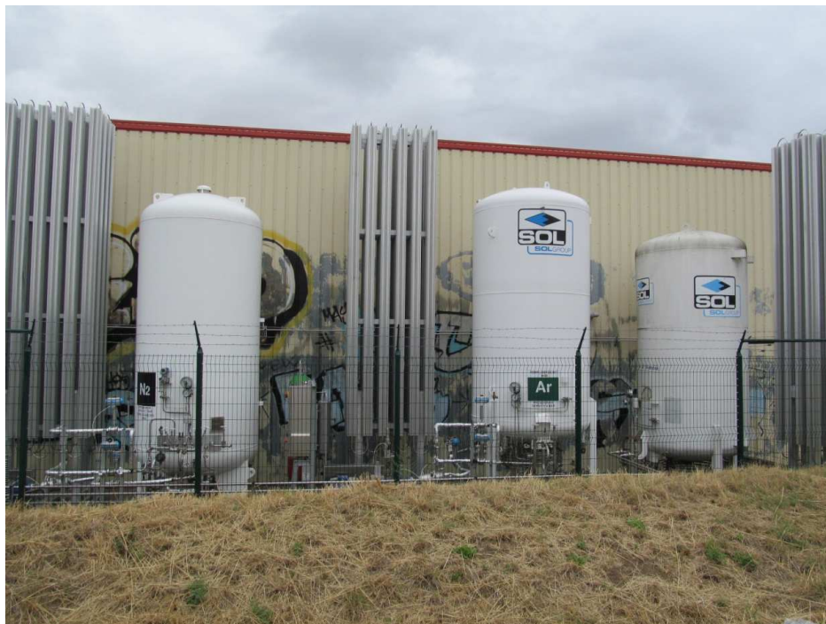
Cuves de stockage Azote / Argon / CO2
